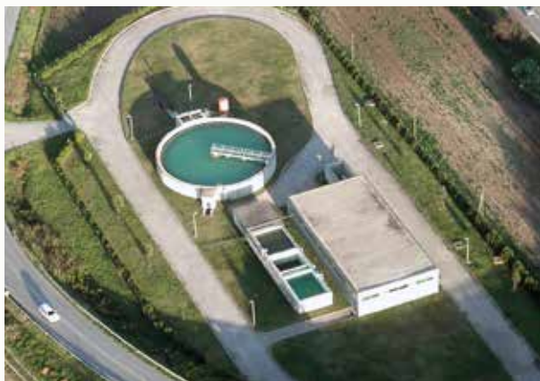
Potabilizzatore di Torno
